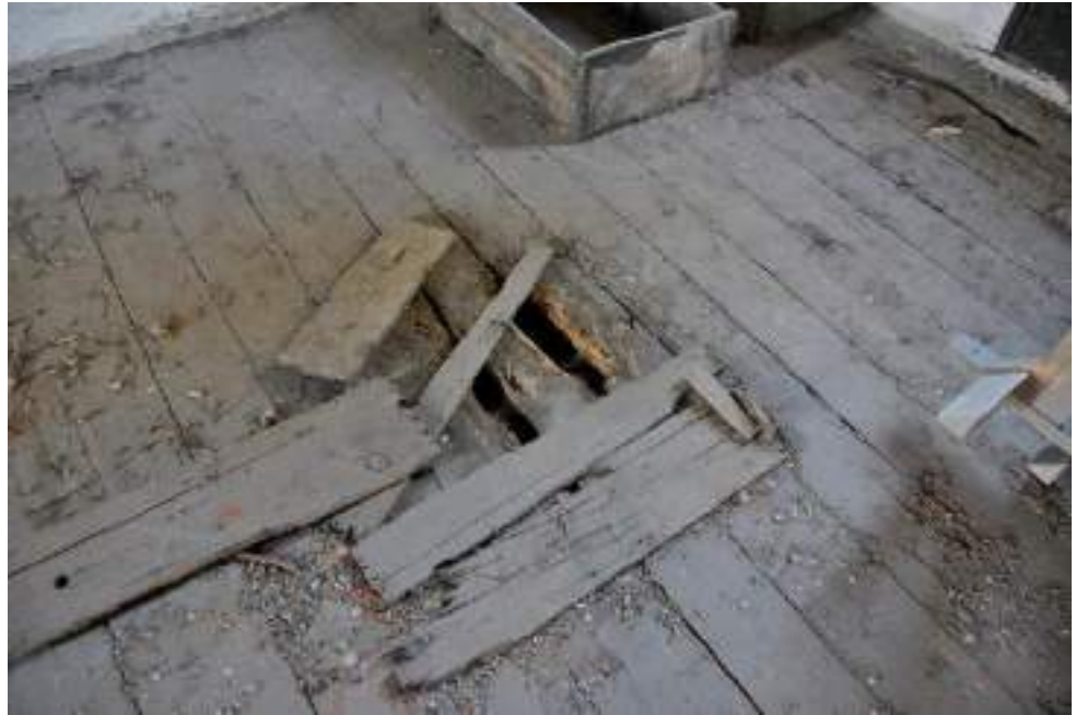
Ammaloramento locale del solaio
